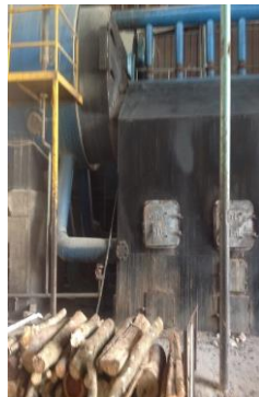
Hình 3. Hình ảnh lò hơi Công ty Nơ Xanh
