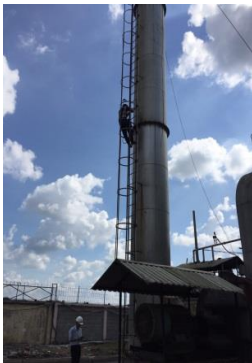
Hình 2. Hình ảnh lò hơi Công ty Hoàn Vũ
