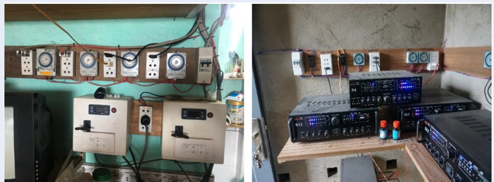
Hình 10: Hệ thống hẹn giờ tự động phát âm thanh trong nhà yến tại huyện Cần Giờ
