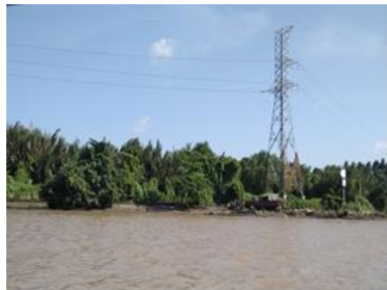
Hình 6. Sạt lở dọc bờ kè trên sông Sài Gòn (ghi nhận từ đợt thực địa tháng 08/2018)
